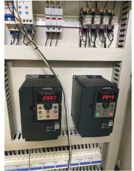
Tủ điện cho quạt thông gió
